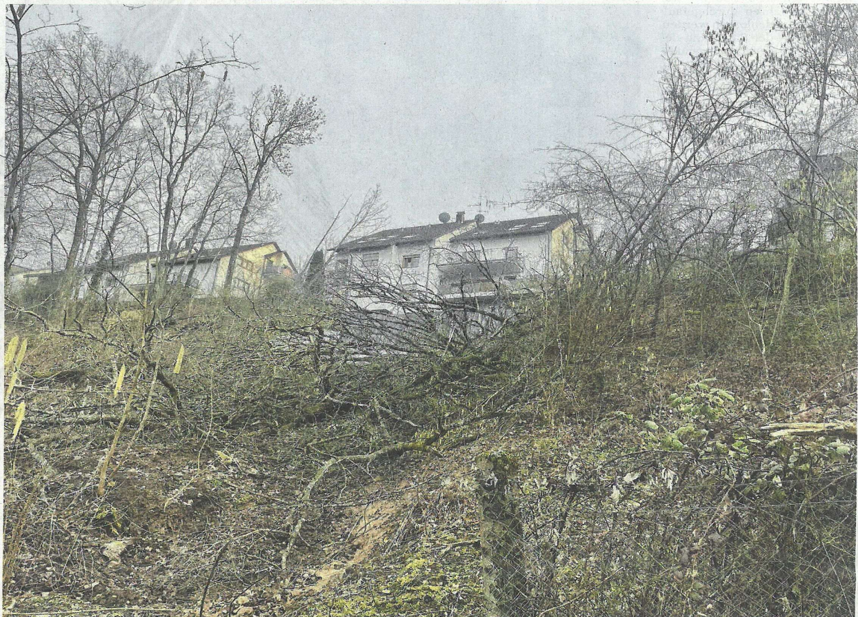
Unterhalb der Gebäude Oberbettringer Straße 79 (links), 77 und 75 ist die Rutschung am Knollenmergelhang noch immer aktiv.
